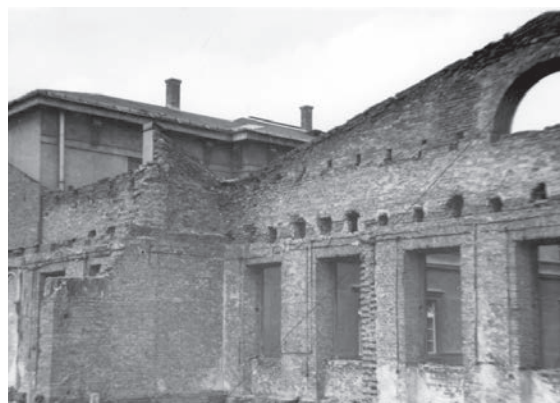
Wypalone stropy w budynku GUM fot. arch. Jerzego Janiszka
